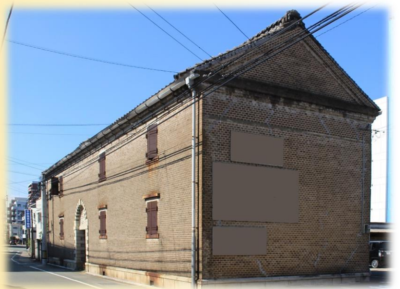
福岡県旧國武合名会社倉庫（写真提供：久留米市）※画像は一部加工しています
